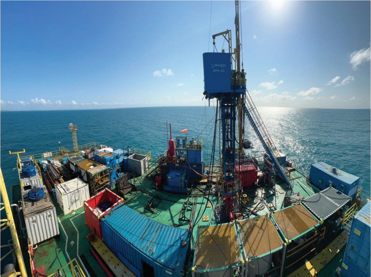
Sonda do tipo SPH atuando em poço na plataforma PCM-6 (Campo de Camorim)
