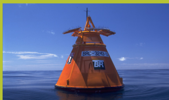
Equipamento instalado no poço marítimo de Paru, em Alagoas
